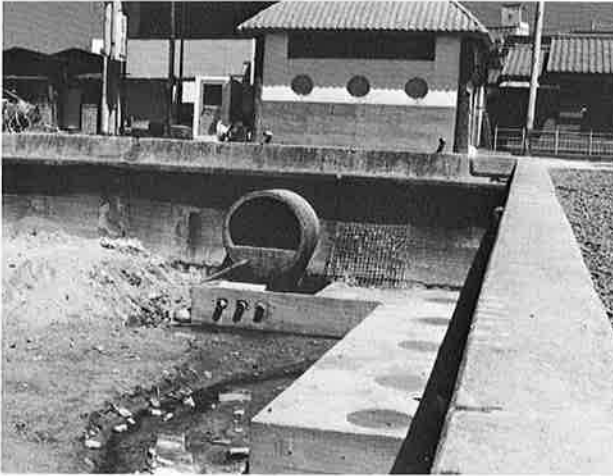
▲入宿川に建設された排水浄化装置
