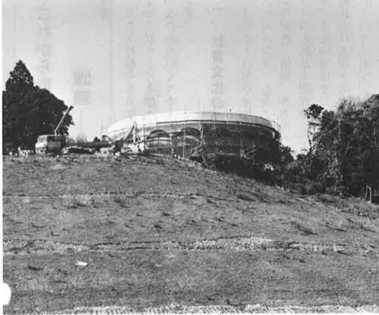
布施・高山田地区と御宿台へ給水するため、新たに 建設される第2配水池
