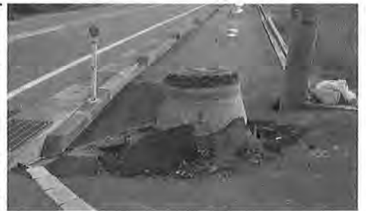
11月17日撮影 地面から突き上げられたマンホール
