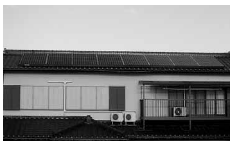
▲補助金の活用により設置された太陽光発電システム
