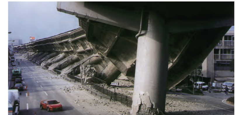
倒壊した阪神高速道路
