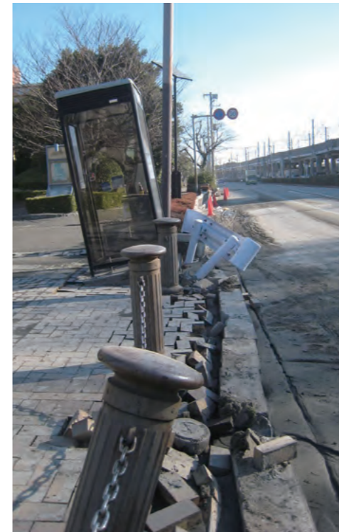
液状化の被害に見舞われた千葉県浦安市
