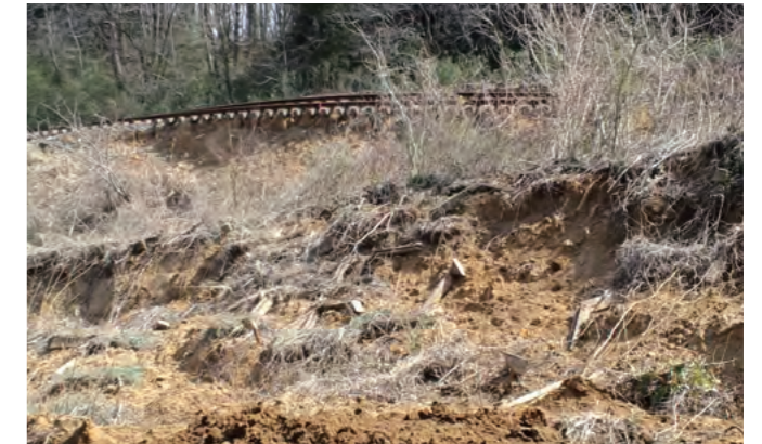
地すべりで、線路が宙づりになってしまった鹿島臨海鉄道
